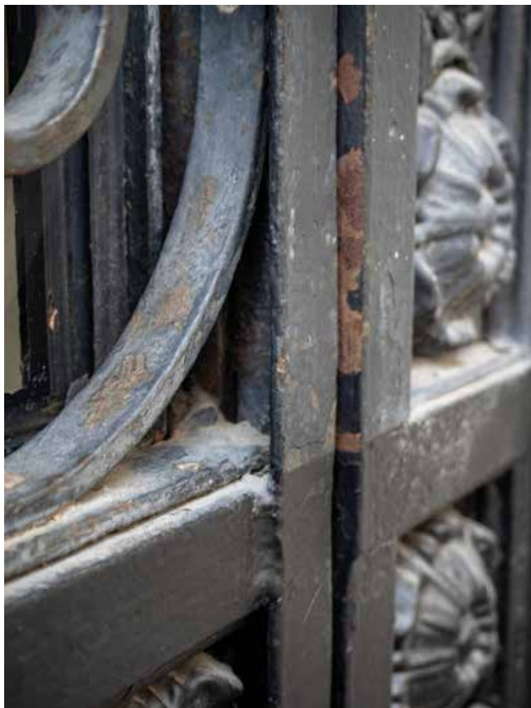
Odszypianie się powłoki lakierniczej na wrotach bramy kamienicy przy ul. Wilczej 22 – nieodpowiednie przygotowanie powierzchni przed malowaniem. Fot. K. Diks
