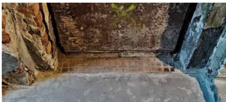
Zalany asfaltem przejazd bramny kamienicy przy ul. Chmielnej 126, przy drzwiach do schowka (?) fragment dawnej nawierzchni. Fot. K. Komar-Michalczyk, 2021
