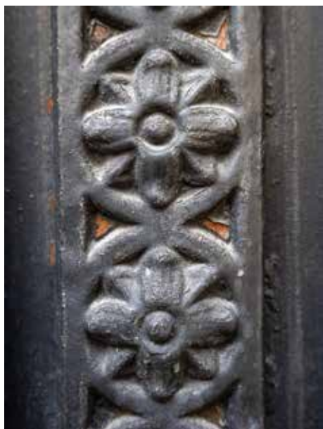
Odpryski farby na fragmencie ornamentu wrót bramy kamienicy przy ul. Wilczej 22 – niedostatecznie oczyszczona powierzchnia przed malowaniem. Fot. K. Diks
