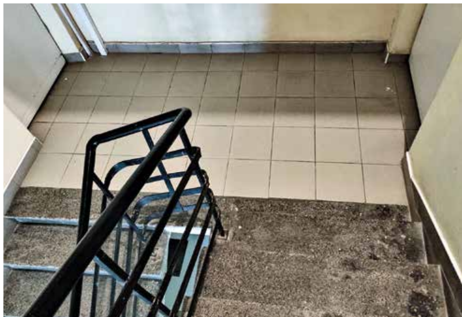
Podesty klatki schodowej kamienicy przy ul. Zgoda 5 – z płytkami historycznymi zachowanymi na ostatniej kondygnacji oraz płytkami współczesnymi na niższych piętrach. Fot. K. Komar-Michalczyk, 2021
