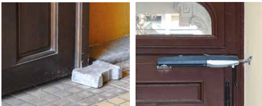
Współczesne systemy i sposoby wymuszania i blokowania ruchu skrzydeł drzwiowych: po lewej widok elektromechanicznego napędu drzwi rozwieranych, zamontowany na drzwiach bramnych kamienicy przy ul. Wilczej 65, z prawej fragment skrzydła nowych wrót przytrzymanych w niewłaściwy sposób za pomocą betonowej kostki brukowej, zaobserwowany w kamienicy przy Al. Jerozolimskich 51. Fot. A. Cichy
