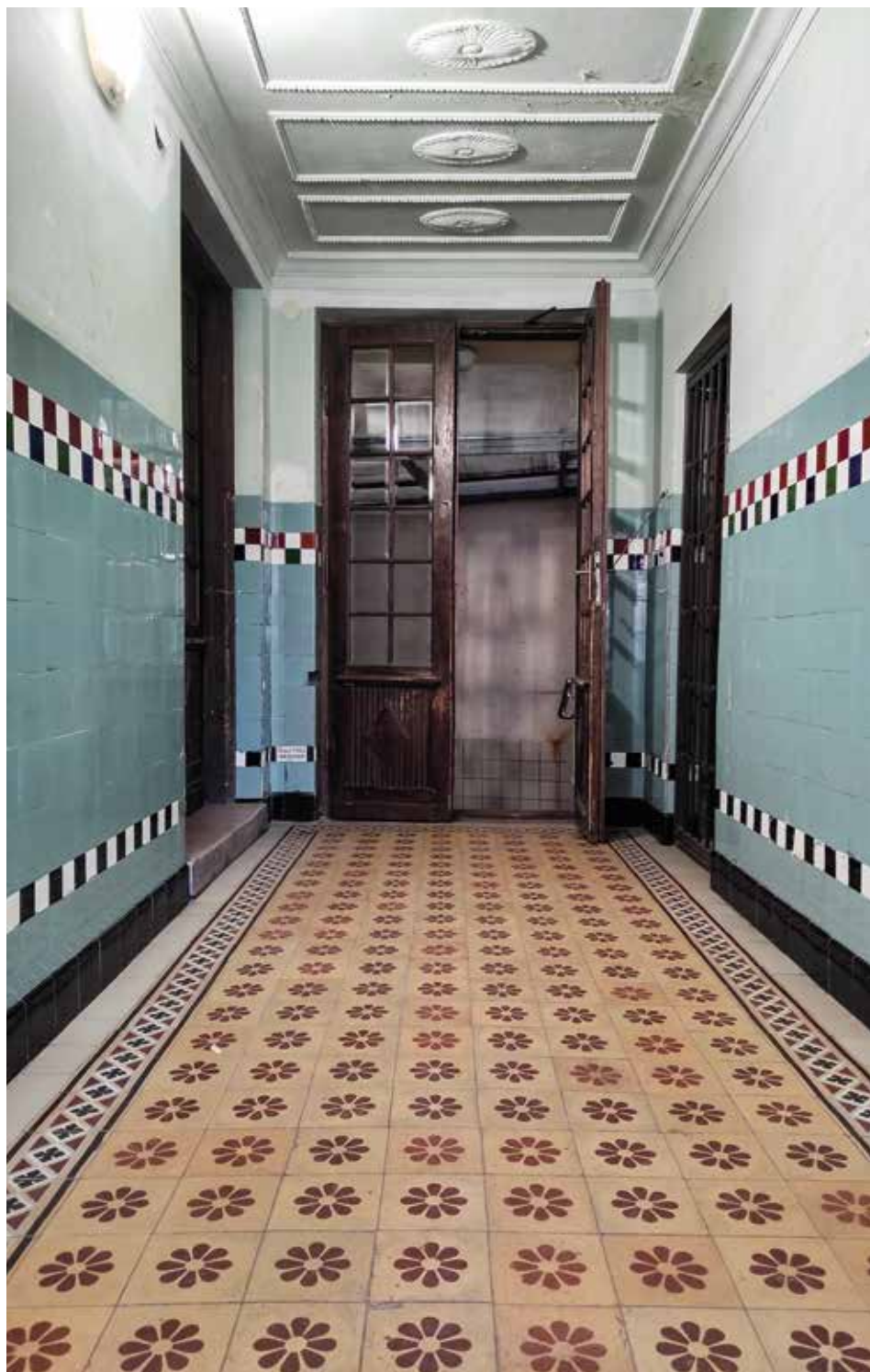
Korytarz klatki schodowej kamienicy przy ul. Pięknej 47 – historyczna posadzka przed remontem oraz po remoncie (skrócenie realizacji od strony ścian) i zniszczone płytki w pojemnikach z „gruzem”. Fot. W. Kmiec
