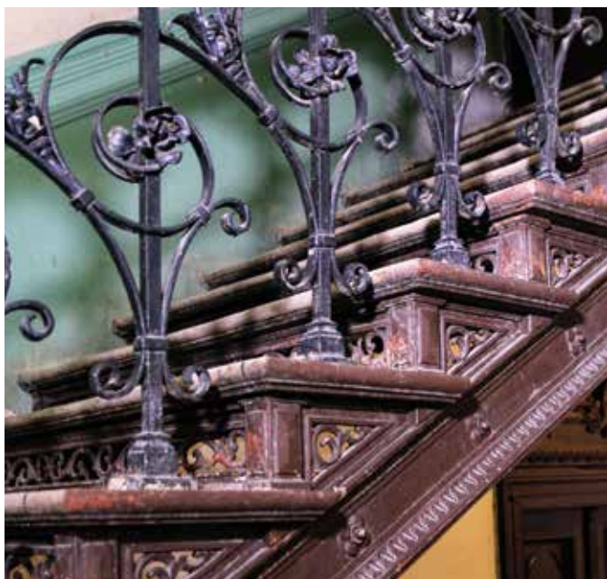
Fragment metalowych schodów w paradnej klatce kamienicy Adolfa Daaba przy ul. Wilczej 32 (1897-1898). Fot. J.S. Majewski
