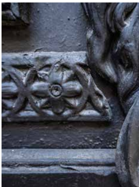
Niestaranne przygotowanie powierzchni wrót bramy kamienicy przy ul. Wilczej 22 przed malowaniem – zamalowane odpryski starej powłoki malarskiej. Fot. K. Diks
