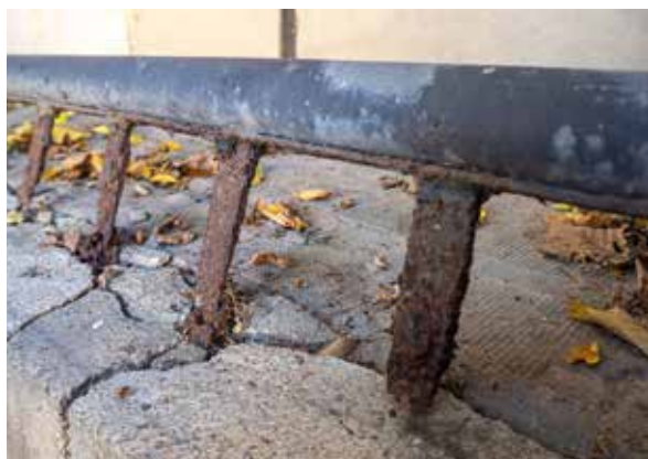
Fragment ogrodzenia przy Pałacu Staszica od strony ulicy Kopernika – zniszczenie korozyjne obiektu w rezultacie braku działań zabezpieczających. Fot. K. Diks
