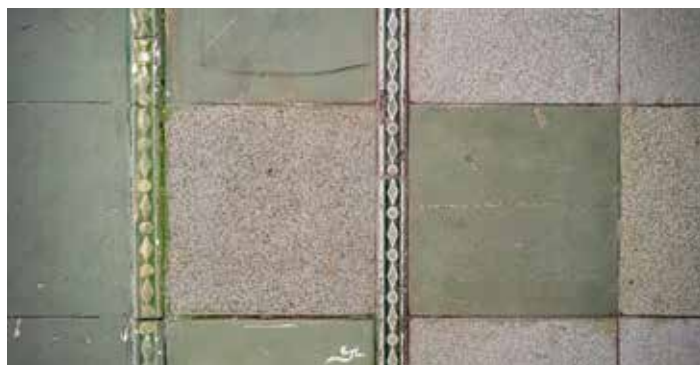
Podesty półpięter klatki schodowej od placu Dąbrowskiego kamienicy przy ul. Kredytowej 9 – z płytkami historycznymi (tzw. gorsecikami) zachowanymi na ostatniej kondygnacji oraz płytkami współczesnymi na niższych piętrach. Fot. K. Komar- Michalczyk, 2021
