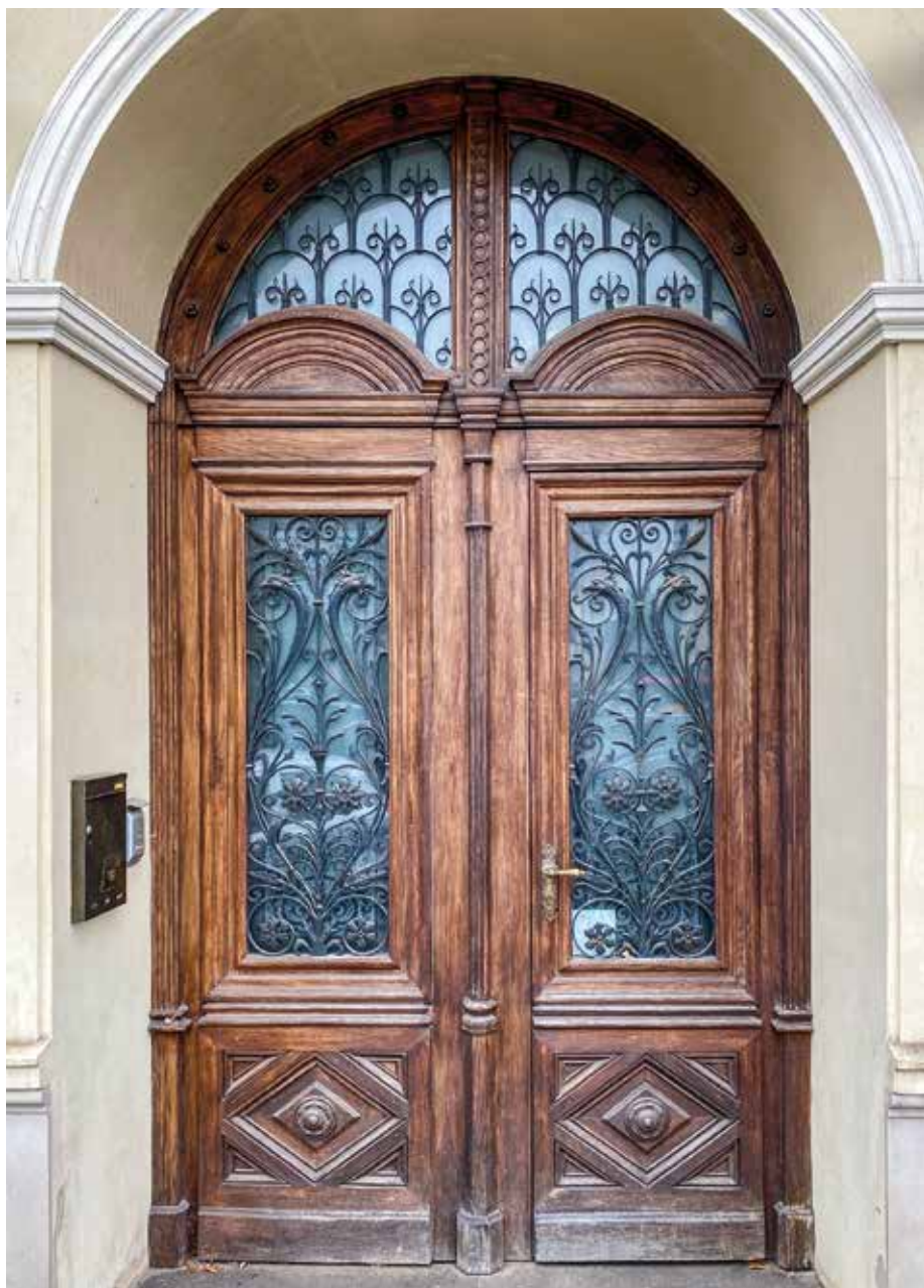
Dobry przykłady rekonstrukcji drzwi przejazdu bramnego w d. pałacu Janaszów przy ul. Zielnej 49. Po 17 latach użytkowania drzwi wymagają tylko odświeżenia powłoki malarskiej. Fot. W. Kmieć
