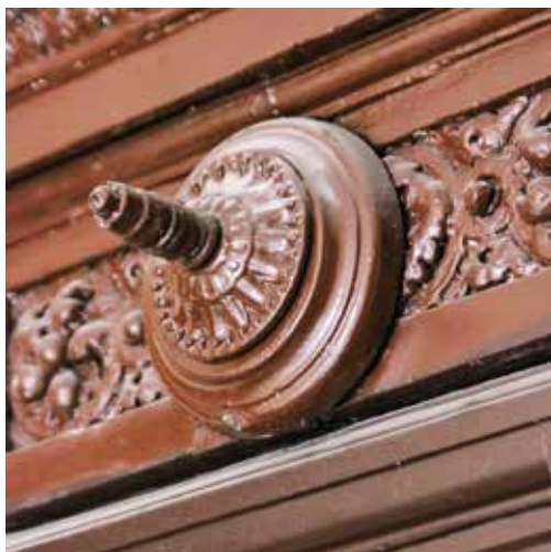
Odcięta rurka gazowa w obramieniu drzwi do jednego z mieszkań w kamienicy przy ul. Hożej 27. Fot. J.S. Majewski
