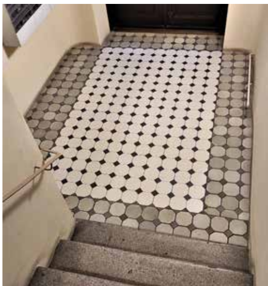
Podest przed biegiem wyrównawczym schodów klatki w oficynie poprzecznej (północnej) kamienicy przy ul. Sienkiewicza 4 – pośrodku płytki współczesne, przy ścianach w charakterze „świadka” pasy płytek historycznych. Fot. K. Komar-Michalczyk, 2021
