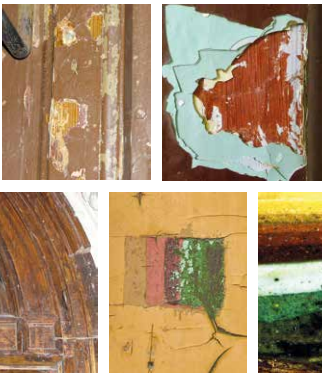
Przykłady malarskich technik dekoracyjnych na stolarnie drzwiowej. Od lewej: mazerunek imitujący drewno sosny na wewnętrznej powierzchni wrót, przykryty wieloma warstwami wtórnych wypraw, ul. Nowogrodzka 19; imitacja drewna (mahoni) wykonana techniką suchego pędzla, Al. Jerozolimskie 47; dębowe elementy wrót pokryte lakierem bezbarwnym, ul. Wiejska 19; warstwy malarskie zalegające na wrotach bramnych ukazane za pomocą odkrywki pasowej i badań mikroskopowych, ul. Targowa 84. Fot. A. Cichy, 2007, 2019, 2024
