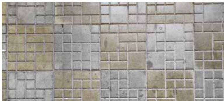
Nawierzchnia przejazdu bramnego kamienicy przy ul. Widoł 20 – z płytek o wymiarach, i podziałach odbiegających od stosowanych w płytkach historycznych. Fot. K. Komar-Michalczyk, 2021
