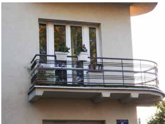
Oczyszczona i zabezpieczona przed korozją balustrada balkonu domu przy ul. Mikołajskiej 5 we Włochach. Fot. W. Weker
