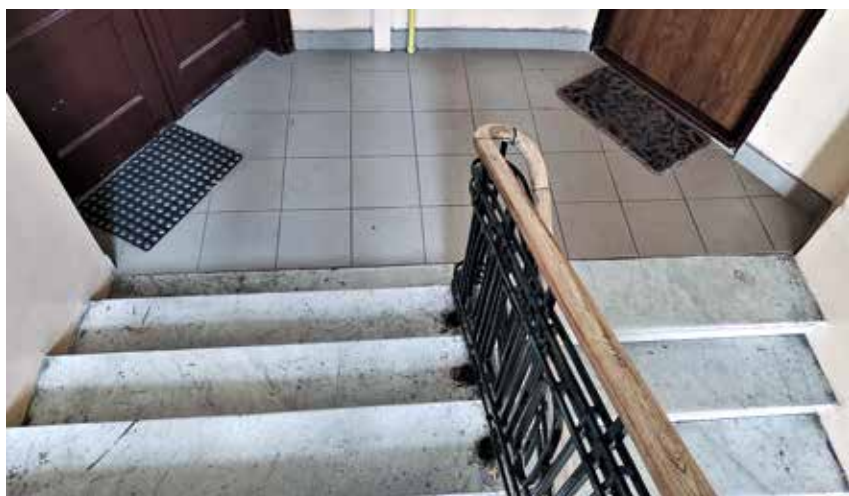
Podesty głównej klatki schodowej w kamienicy przy ul. Chłodnej 34 – z płytkami pierwotnymi i współczesnymi, niemającymi nic wspólnego z pierwotną okładziną.
