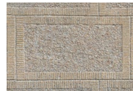
Dom przy ul. Berezyńskiej 29a, tynk szlachetny barwiony w masie, który poddano obróbce kamieniarskiej po związaniu wyprawy; opracowanie ma przypominać bloki kamienne. Fot. K. Onisk
