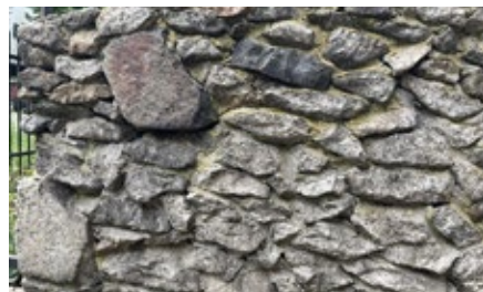
Mur wzdłuż chodnika prowadzącego do drzwi wejściowych domu przy ul. Katowickiej 8a. Fot. K. Onisk
