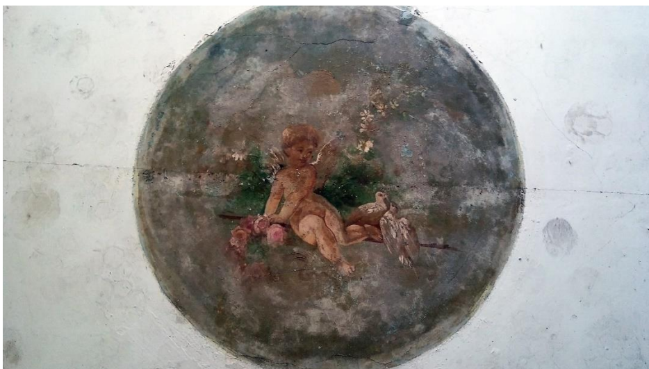
Zdj. 1. Malatura na sklepieniu przejazdu bramnego, Inżynierska 9
