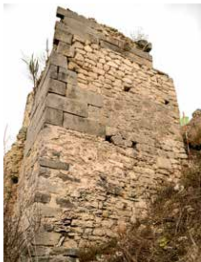
Ryc. 3.6. Ilża, ruina zamku – fragment zniszczonego czworobocznego fragmentu bramy wjazdowej prowadzącej na zamek górny, zwietrzałe ciosy wapienne, łączone zaprawą wapienno-piaskową, widoczne otwory po rusztowaniu, w górnej i środkowej części, oblicowanie ze starannie opracowanych prostokątnych płyt (XV w.). Widok od strony (fot. R. Zapłata / RZ/LK)
