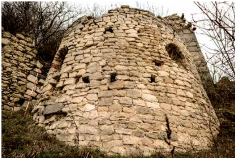
Ryc. 3.5. Iłża, ruina zamku – basteja ze strzelnicami kluczowymi umieszczona przy bramie wjazdowej (XVI w.), ciosy wapienne łączone zaprawą wapienno-piaskową, widoczne otwory po rusztowaniu. Widoczne zmiany powierzchni substancji zabytkowej m.in. nalot z mchu, ubytki i rozluźnienia spoinowań. Widok od strony SW (fot. R. Zapłata / RZ/LK)
