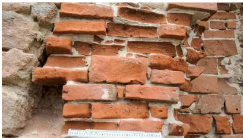
Ryc. 3.48. Ilża, zamek górny – silnie skorodowany fragment muru ceglanego (fot. R. Zapłata - RZ)
