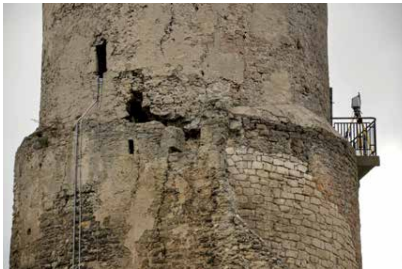
Ryc. 3.13. Iłża, ruina zamku (stan 2011 r.). Fragment wieży głównej wzniesionej na planie kolistym z ciosów wapiennych łączonych zaprawą wapienno-piaskową, znajdującej się we wschodnim narożu założenia (XIV w.) z widocznymi ubytkami, szczelinami i spękaniami; widoczne zróżnicowanie surowcowe muru wieży i stopnia zniszczenia; pozostałości na znacznej powierzchni tynków pochodzących z późniejszych okresów remontu zamku; uzupełnienia fragmentu ściany; widok od N (fot. R. Zapłata / RZ)
