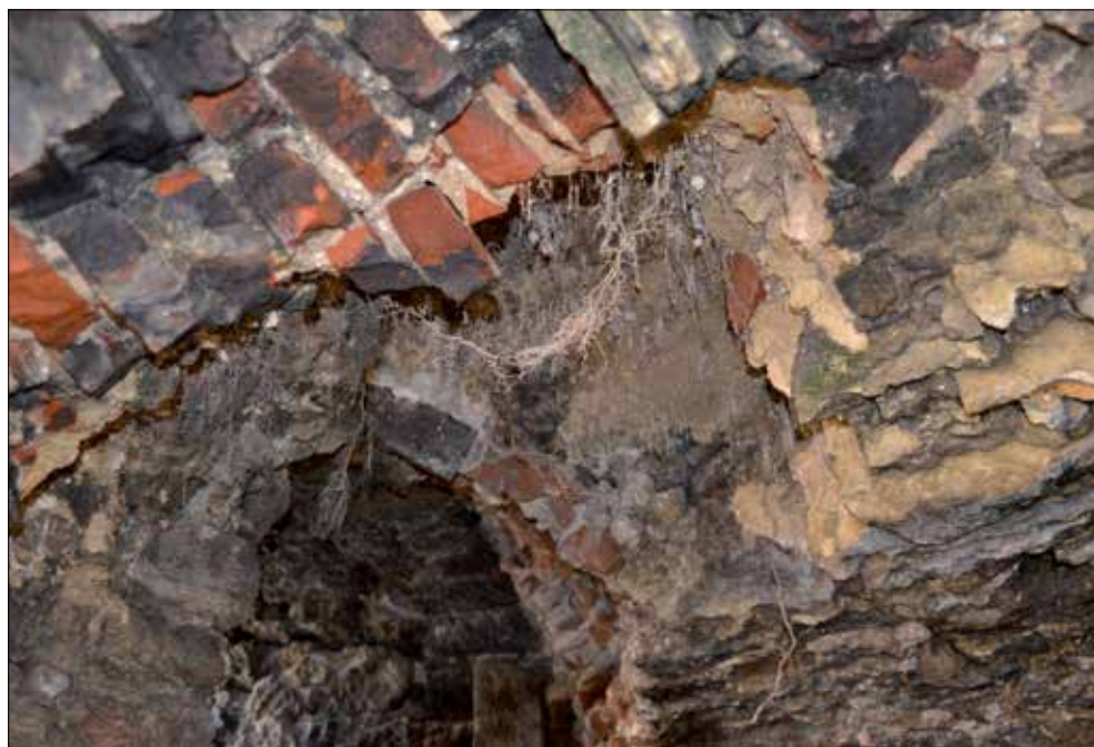
Ryc. 3.41. Iłża, fragment ruin zamku górnego – sklepienie piwnicy. Widoczne ubytki – destrukcja spoinowań i cegieł (fot. R. Zapłata)
