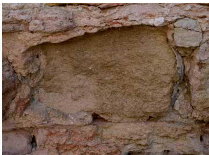
Ryc. 3.18. Ilża, ruina zamku górnego. Przykładowe fragmenty lica muru z wyraźnymi powierzchniowymi ubytkami substancji zabytkowej (po lewej) wieża zamkowa – zwietrzały wapień (muszlowiec) i wymyte spoinowania, (po prawej) lico muru jednej z komnat zamkowych – zwietrzały piaskowiec droбноziarnisty (fot. R. Zapłata)
