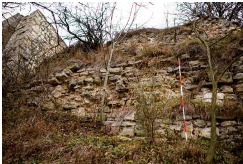
Ryc. 3.54. Ilża, zamek górny – widok od zachodu na silnie skorodowaną elewację muru obwodowego (fot. R. Zapłata – RZ)
