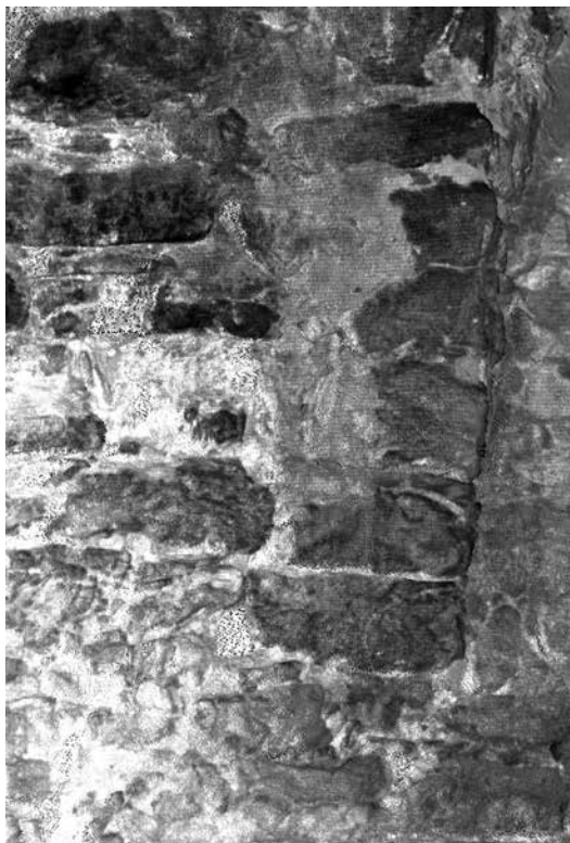
Ryc. 3.26. Iłża, fragment muru jednej z piwnic zamkowych – obraz intensywności odbicia wiązki lasera. Powierzchnia występowania mikroorganizmów – jaśniejszy odcień. (oprac. fotogram. Politechnika Warszawska)
